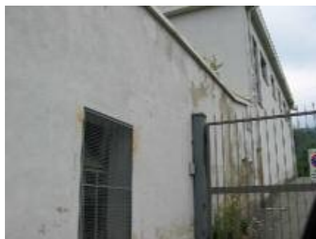
Foto 3: Locato Inf., cabina Enel
